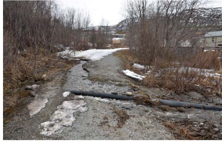
Vårløsning skaper problemer med veien i fjæra i Hjemmeluft.
