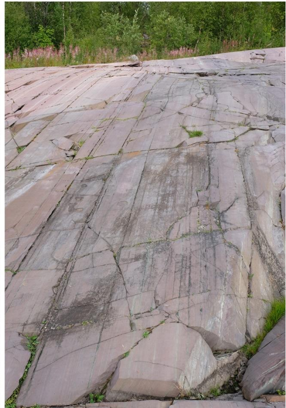
Det er flere partier på Kåfjordfeltet der det jevnlig siger vann, og her kommer det fort alger og lav. Bildet er tatt etter sommeren 2023, uten spriting.
